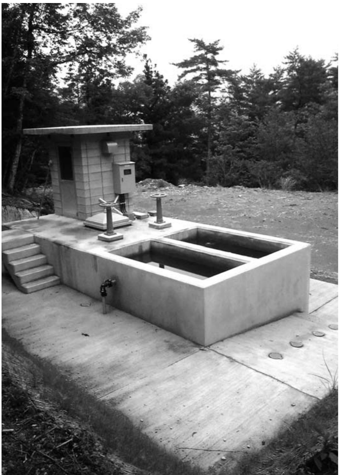
三津子野地区簡易給水施設
