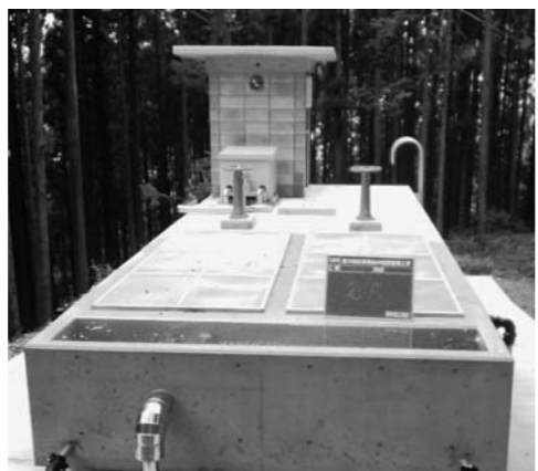
西川地区簡易給水施設浄水場
