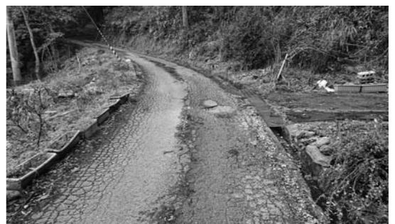
補修が必要な町道
