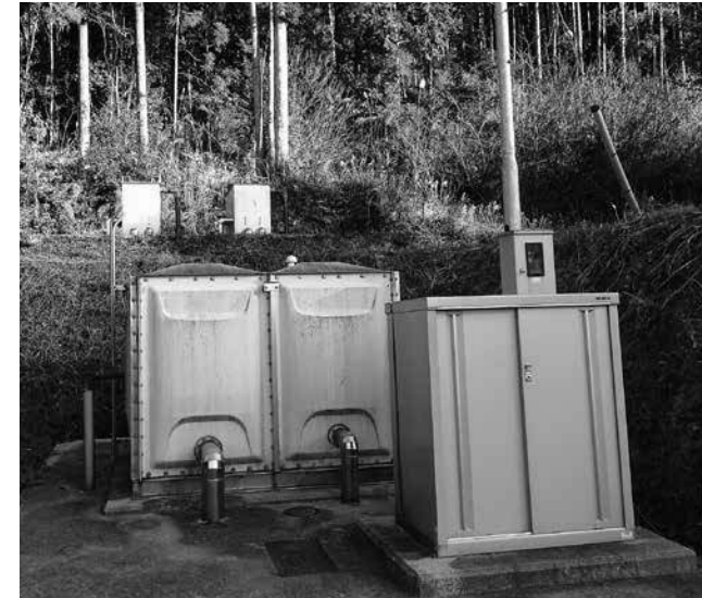
簡易給水施設
