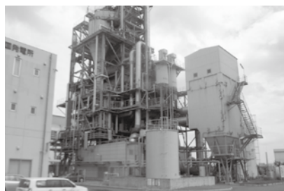
バイオマス発電所
