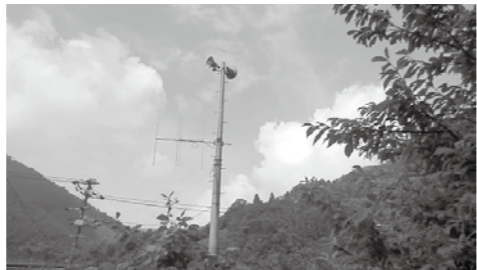
防災屋外放送施設
