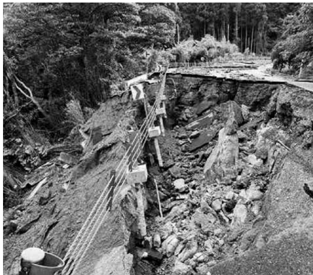
地すべりエリア 路面崩壊
