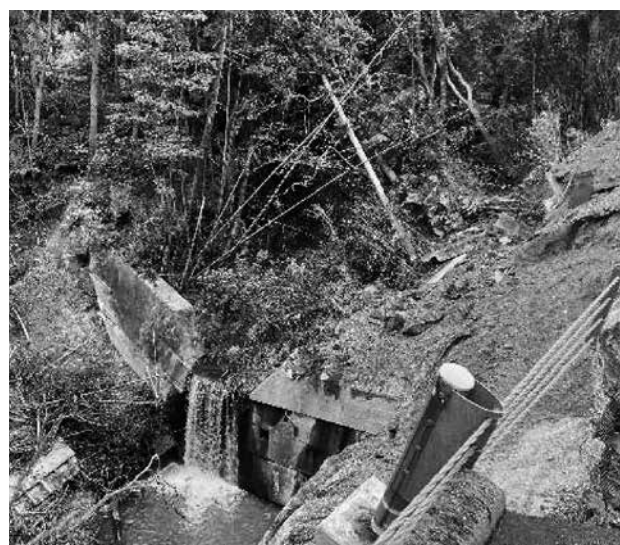
地すべりエリア 斜面崩壊
