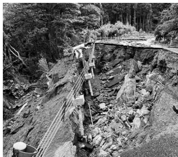
地すべりエリア 路面崩壊
