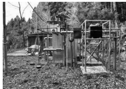
東庵谷簡易給水施設
