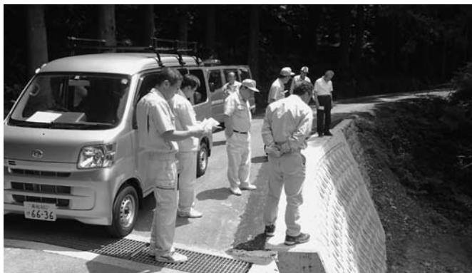
町道東土居岩原線災害箇所調査（八川地区内）
