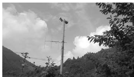
防災屋外放送施設
